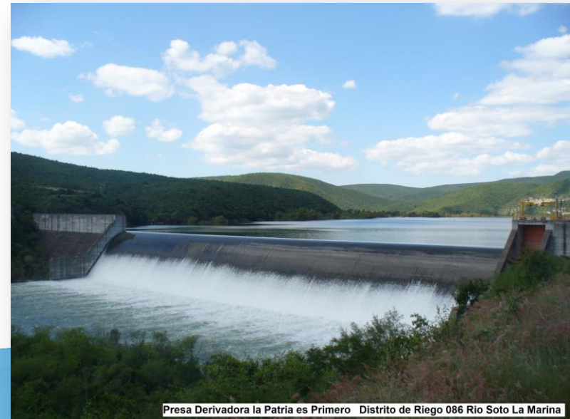
Presas Derivadora la Patria es Primero Distrito de Riego 086 Río Soto La Marina
