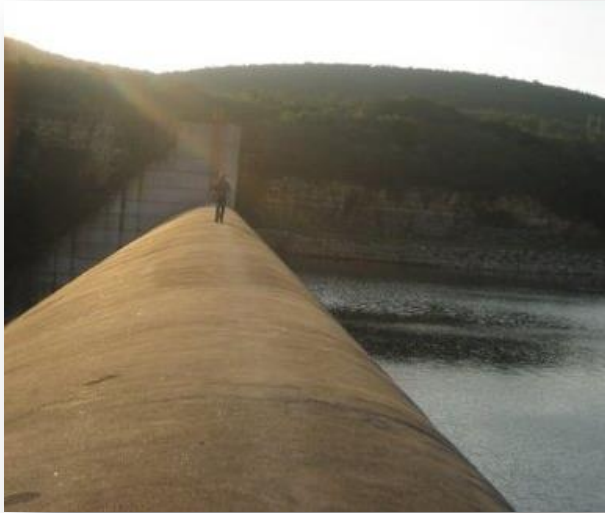
Vertedor Presa derivadora La Patria es Primero.
